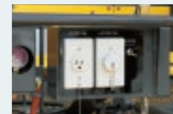
コンセント部
