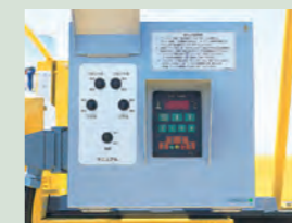
コントロールボックス
