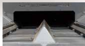
コンベヤ中央チェーンカバー
